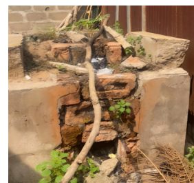
Incinérateur actuellement hors service suite à une panne récente
