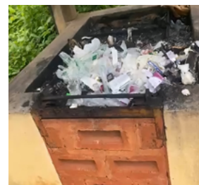
Incinérateur non utilisé à cause de son état de défectuosité
